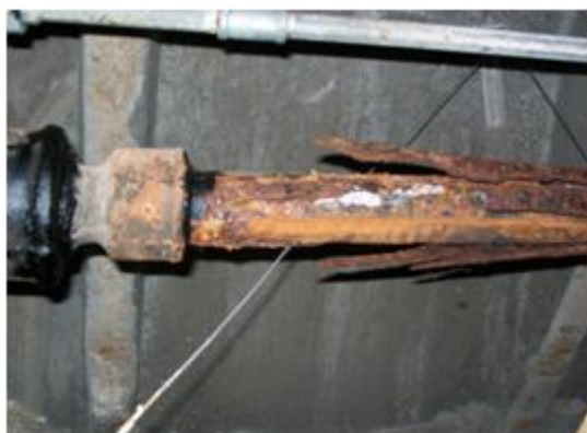
Figura 2 Foto que muestra el resultado de la agresividad de los residuales en las instalaciones hidráulicas correspondiente a la red hidráulica de las instalaciones de laboratorios docentes de química de la Universidad de Matanzas “Camilo Cienfuegos”. Fuente: Propia.
